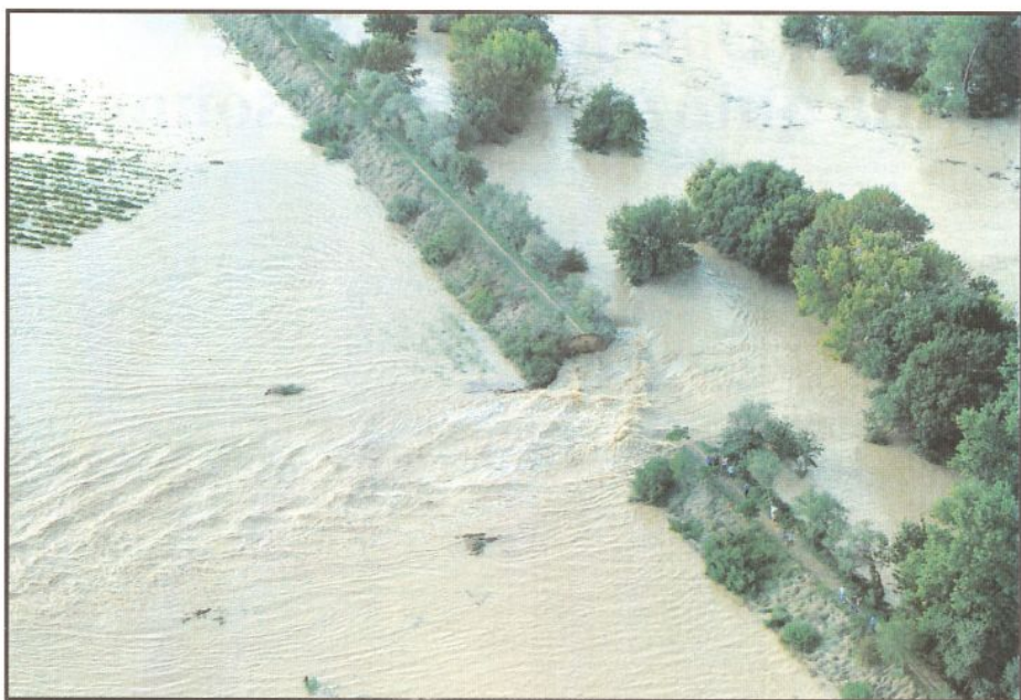
Vers 16 heures, peu après le déversoir de Gallargues, la digue a cédé. La vague a dévasté les vignes avant de couper la route de Nîmes.
